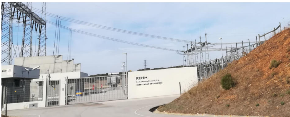
Figura 4.49 - Subestação de Estremoz
